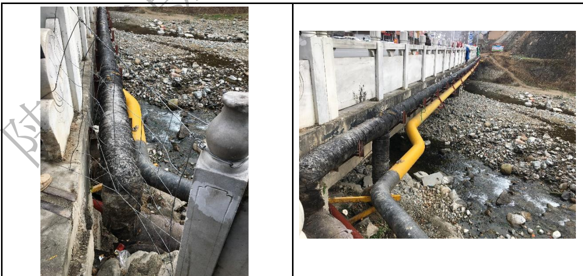
供气管网跨越河流
